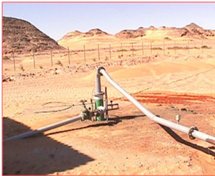
Injection Well (Tushka)
